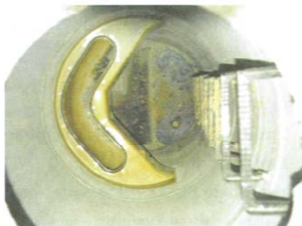
Unvorteilhafte Hydraulik gegenüber anderen Kombischächten: Zusätzliche Abwicklungen in der Regenwasserleitung behindern den Abfluss.
