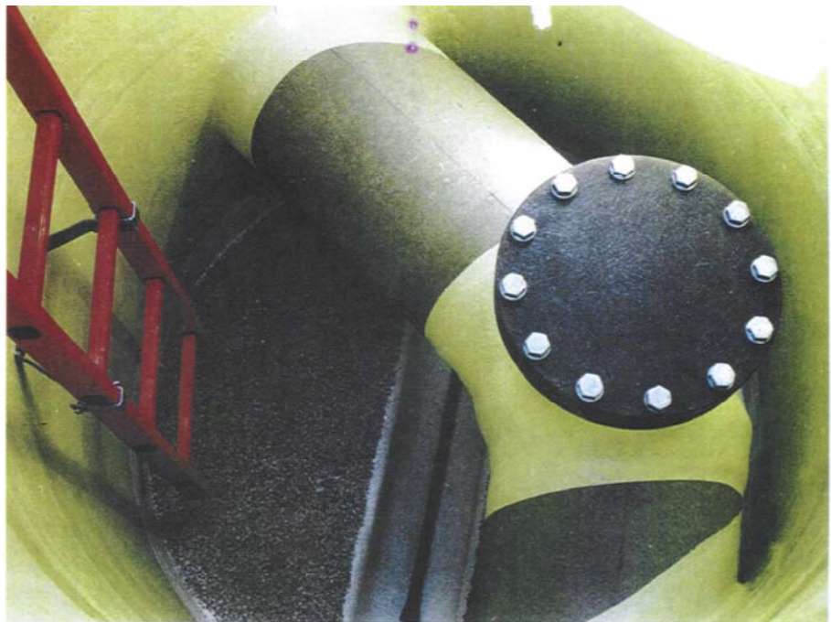
Nicht Betreiberfreundlich: Geringe Durchstiegsfreiheit und aufwendig zu öffnende und zu schließende Revisionsklappe.
